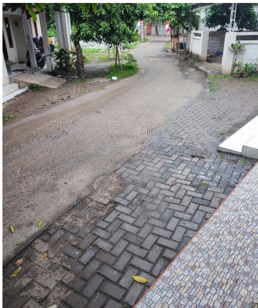
Gambar 3.6 Kondisi Jl. Raya Tanjung Burung
